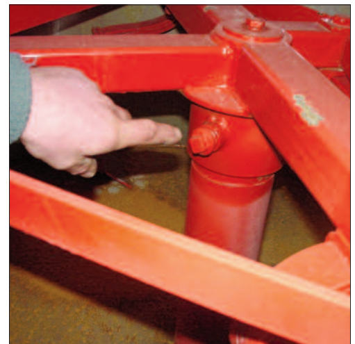
4) Schmierstelle Mischkreuz oben kontrollieren/nachfetten, Mischblätter auf Verschleiß prüfen
